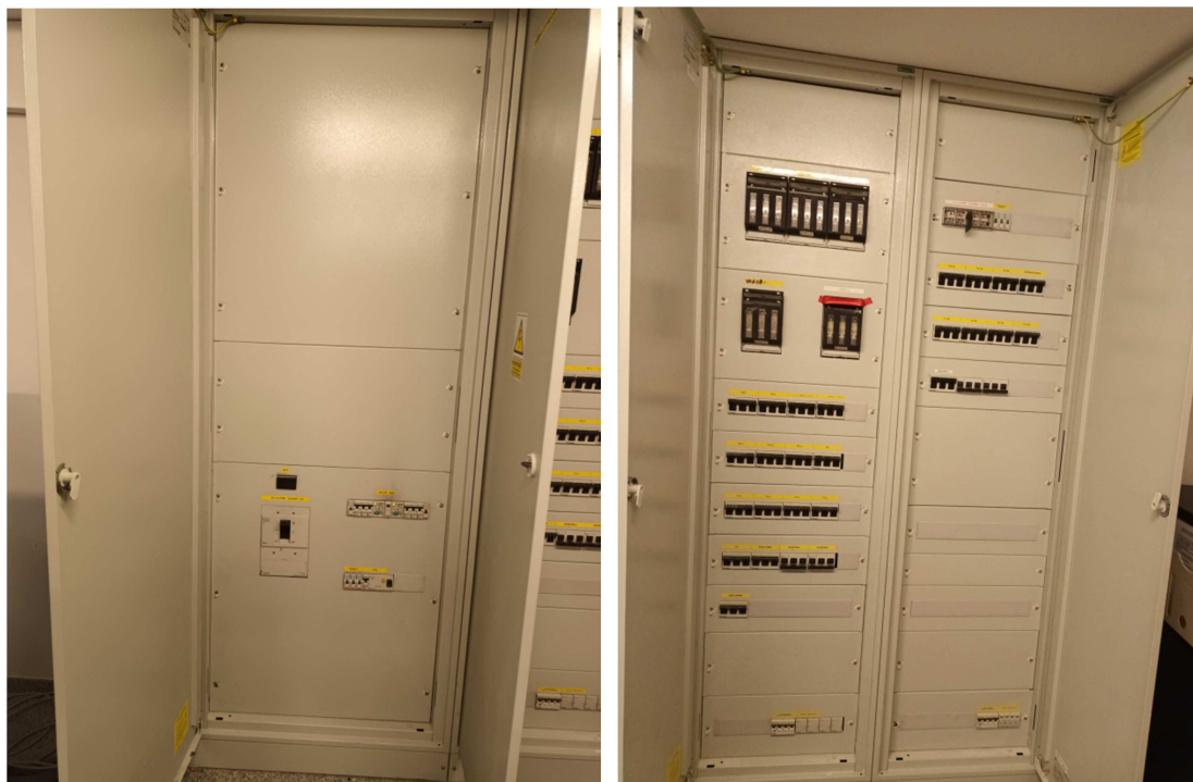
Widok rozdzielni głównej RG budynku
